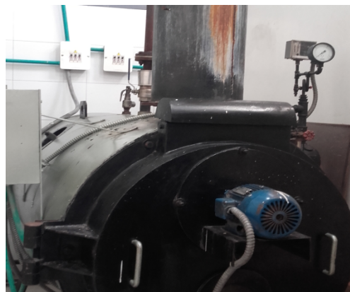
FOTOGRAFIA 5. DUCTO DE DESFOGUE CALDERA
