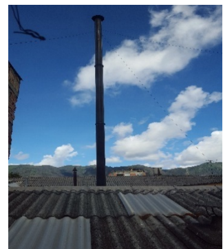
FOTO 6. DUCTO DE LA CALDERA
