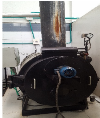
FOTO 5. CALDERA DE 20 BHP
